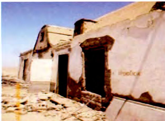
Figura N°03. Colapso de bodegas
