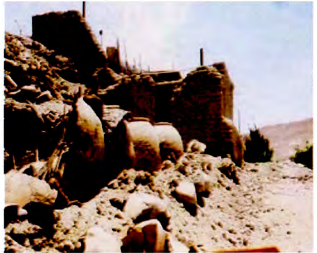
Figura N°04. Pérdida de estructura
