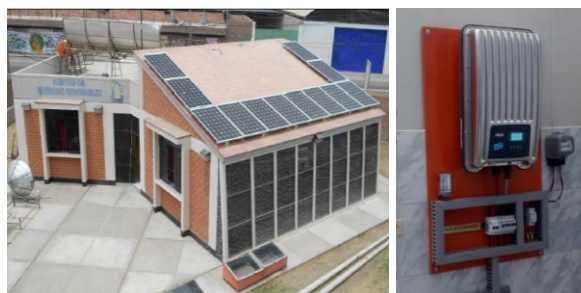
Figura 2. Sistema Fotovoltaico conectado a la red eléctrica de la Ciudad Universitaria de la UNJBG, en el techo del CERT e inversor inteligente DC/AC e interfaces de sensores
