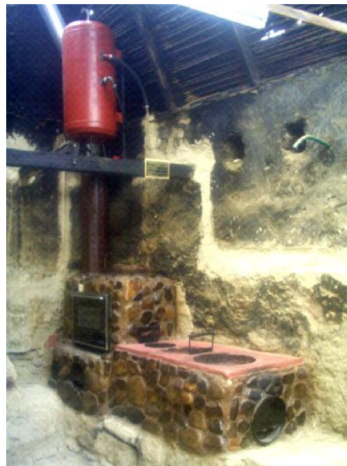
Figura N°06: Imagen del sistema completo de cocina mejorada con tanque almacén para agua caliente.
